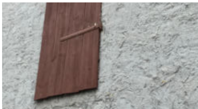
Negativbeispiel: Rauer Spritzputz
