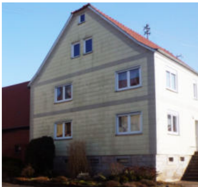
Negativbeispiel: Unpassende Fassadenverkleidung
