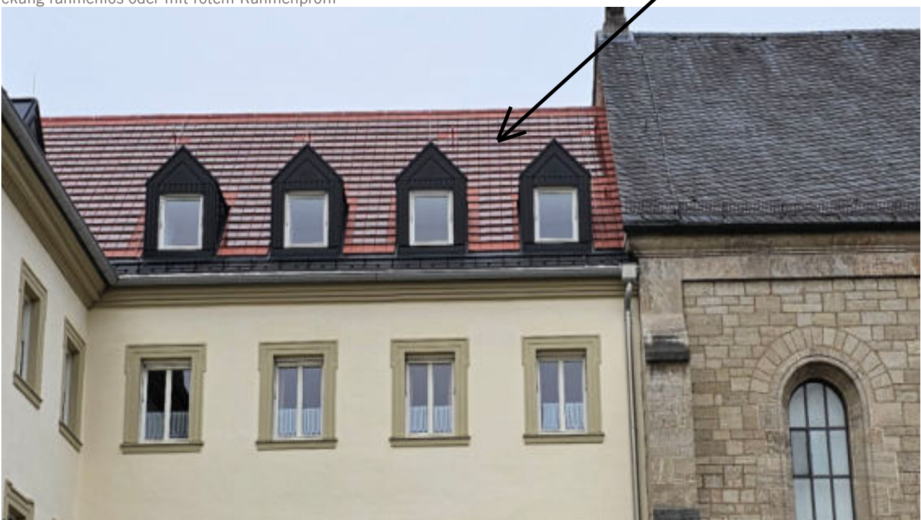
Solarziegel auf saniertem historischem Gebäude - Klosteranlage der „Erlöserwestern“ Würzburg, rot
