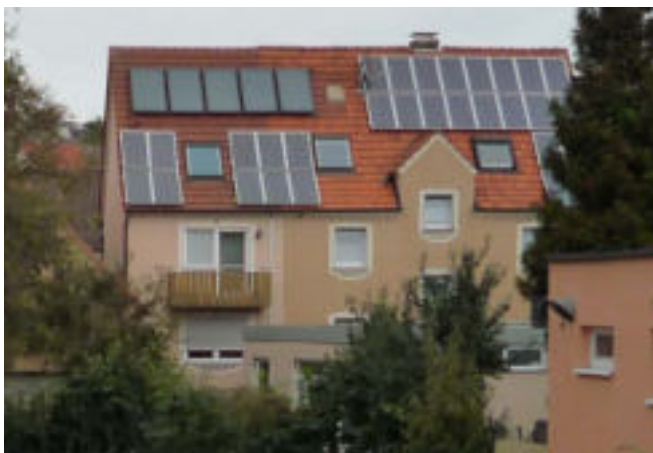
Negativbeispiel: Ungeordnete PV- Anlagen verunklaren die Dachlandschaft
