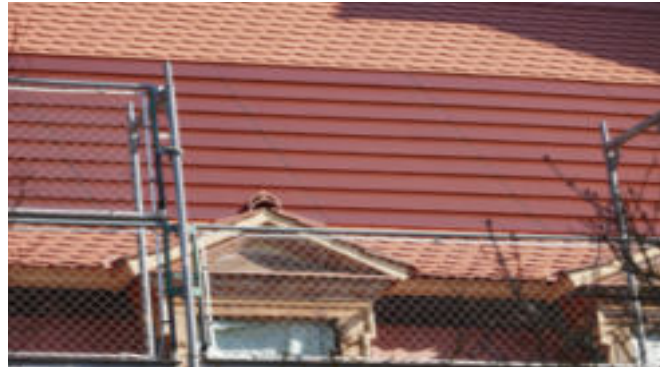
Integrierte horiz. Solarpaneele in Anmutung Ziegelreihe, rot
