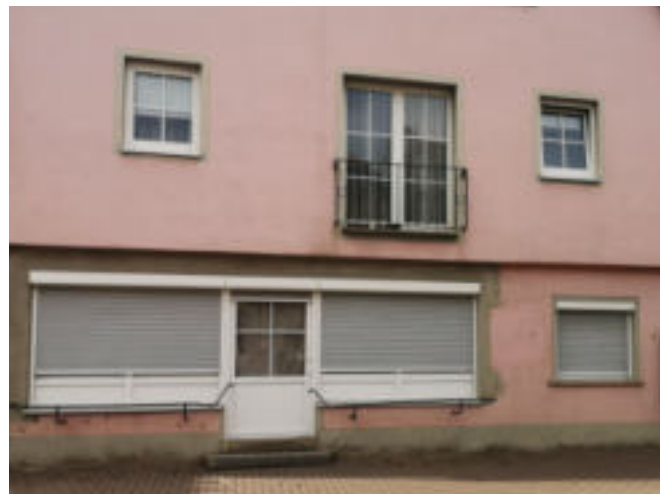
Negativbeispiel: Unharmonische Fassadengestaltung durch nicht aufeinander abgestimmte Fensterformate und -anordnung
